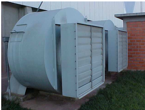
Figura 7 – Ventilador ou exaustor
